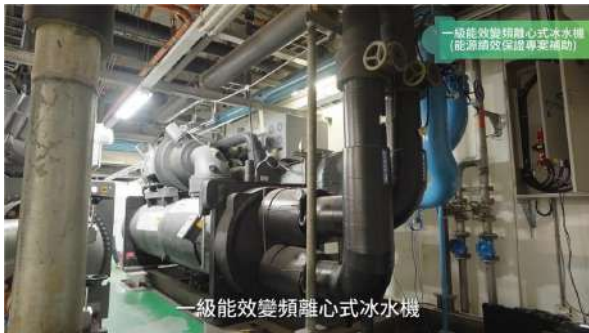
▲ 冰水主機汰換為變頻節電（節能率 33%，年省電 114 萬度）
